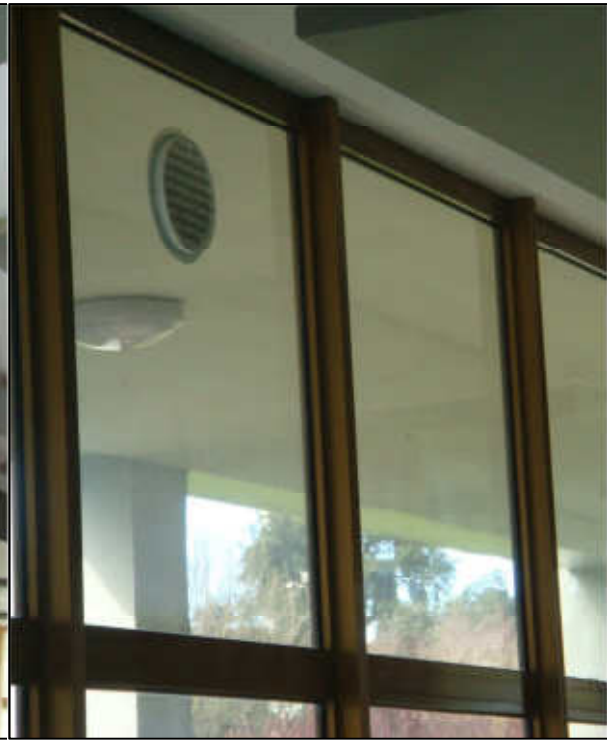
Foto 2 – Sistema de ventilação da sala de refeições da unidade alimentar da ESE
